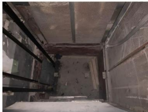
На фото приямки лифтов, на верхнем фото отсутствует вертикальный штифт под порогом, двери шахты лифта
