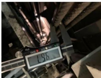
На фото показано физический износ стальных канатов и просадка люнок КВПШ Лифта № 1. Заяв. № 174796
