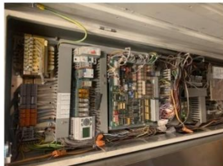
На фото показано состояние шкафа управления лифтом
