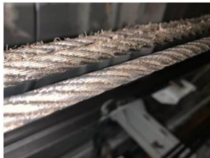
На фото показано физический износ тяговых канатов и просадка дунок КВШ. Лифта № 5. Зап. № 174799
