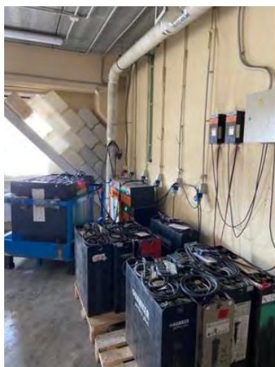
Фото № 13. Нежилое помещение аккумуляторной
