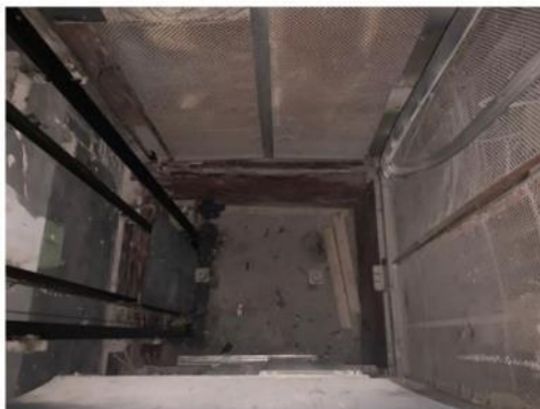
На фото привалки лифтов, на верхнем фото отсутствует вертикальный штифт под порогом двери шахты лифта
