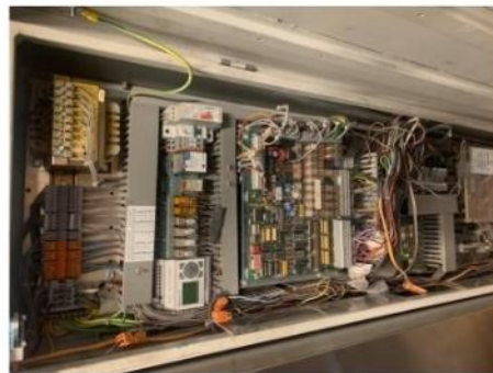
На фото показано состояние шкафа управления лифтом
