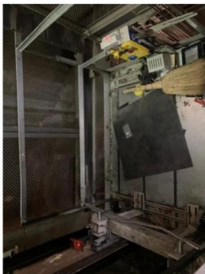
На фото внешний вид крышки кабины лифта
