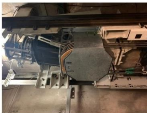
На фото внешний вид лебедки главного привода
